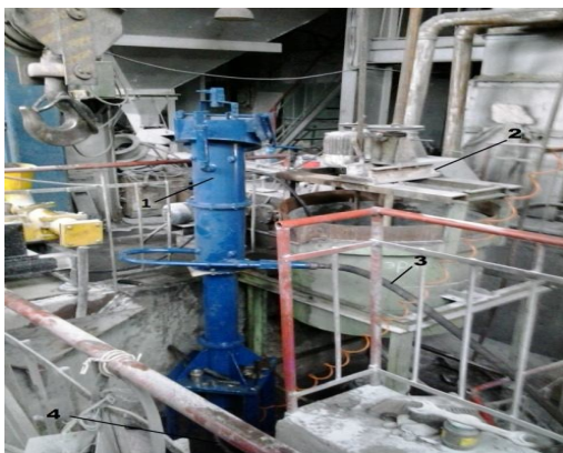
1-колонная флотомашина, 2-емкость с мешалкой, 3-подводящий трубопровод от насоса, 4-трубопровод вывода хвостов флотации
